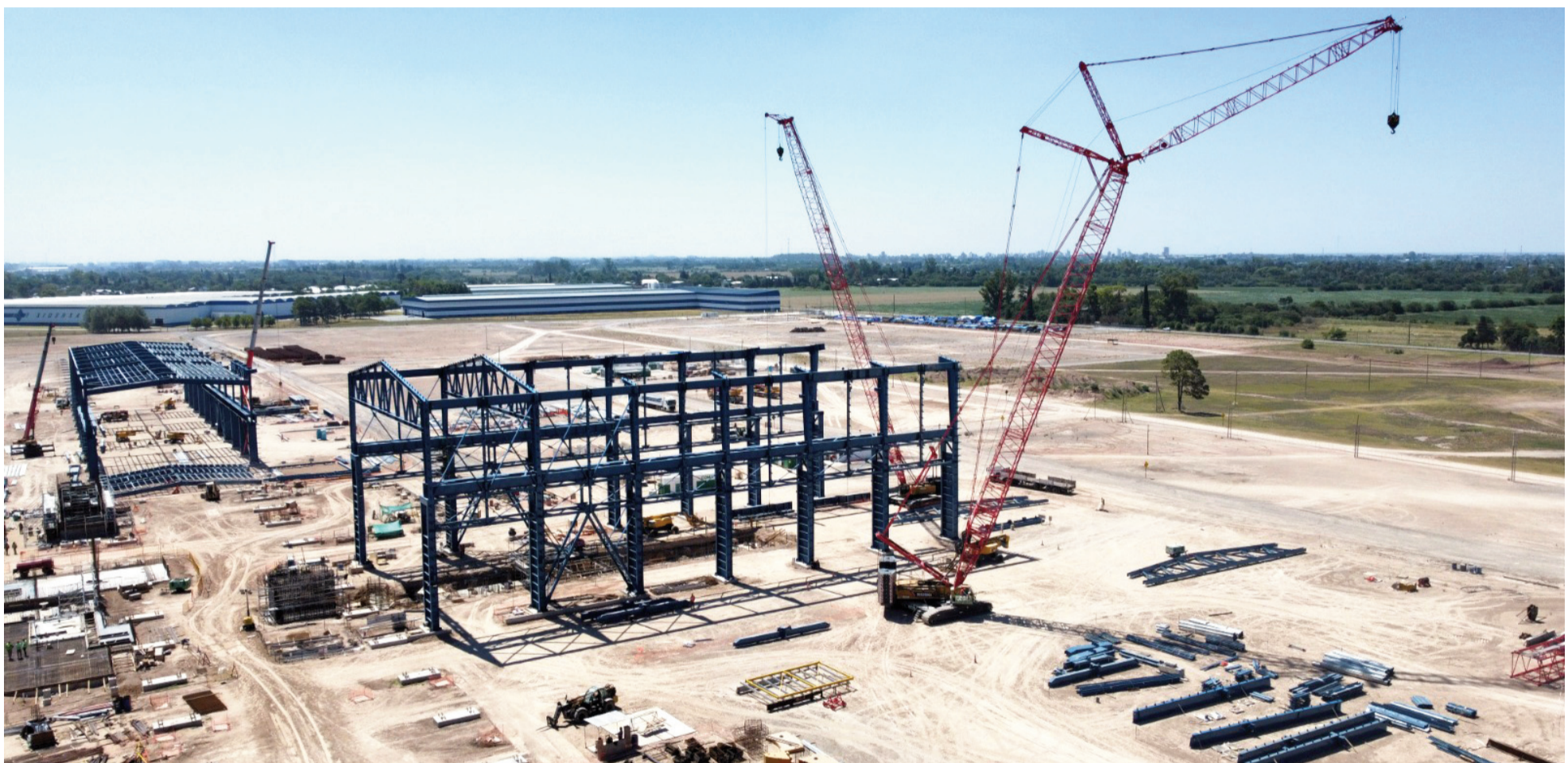
Sidersa avanza con la construcción de una nueva planta que la posicionará como un referente internacional en la producción de acero verde.
