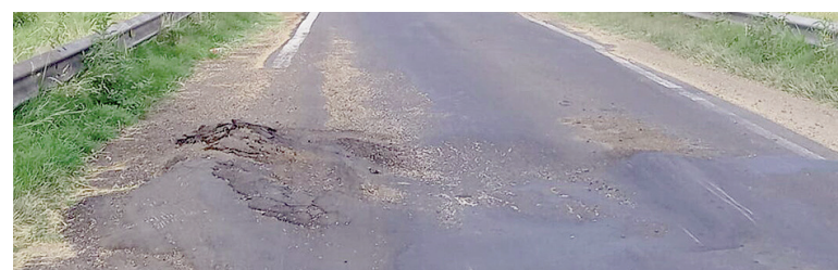
Los arreglos ordenados por la Justicia no trajeron soluciones duraderas: el pavimento sobre el acceso al puente de la Ruta 51 volvió pronto a deteriorarse. GENTILEZA: SNR HOY
