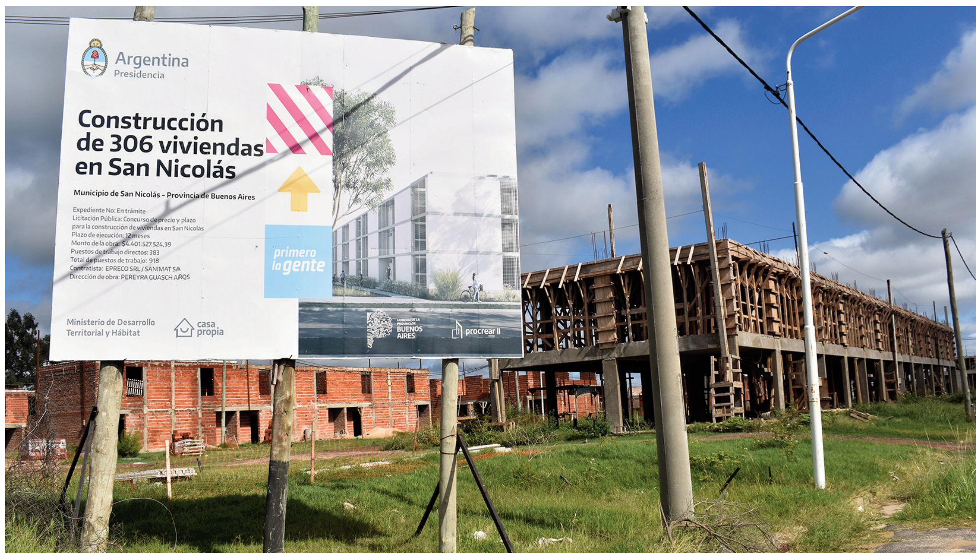
Cartel e inicio de obra: los trabajos comenzaron a ejecutarse en abril de 2023 y para febrero del año siguiente ya estaban frenados e inconclusos. ARCHIVO / EL NORTE
