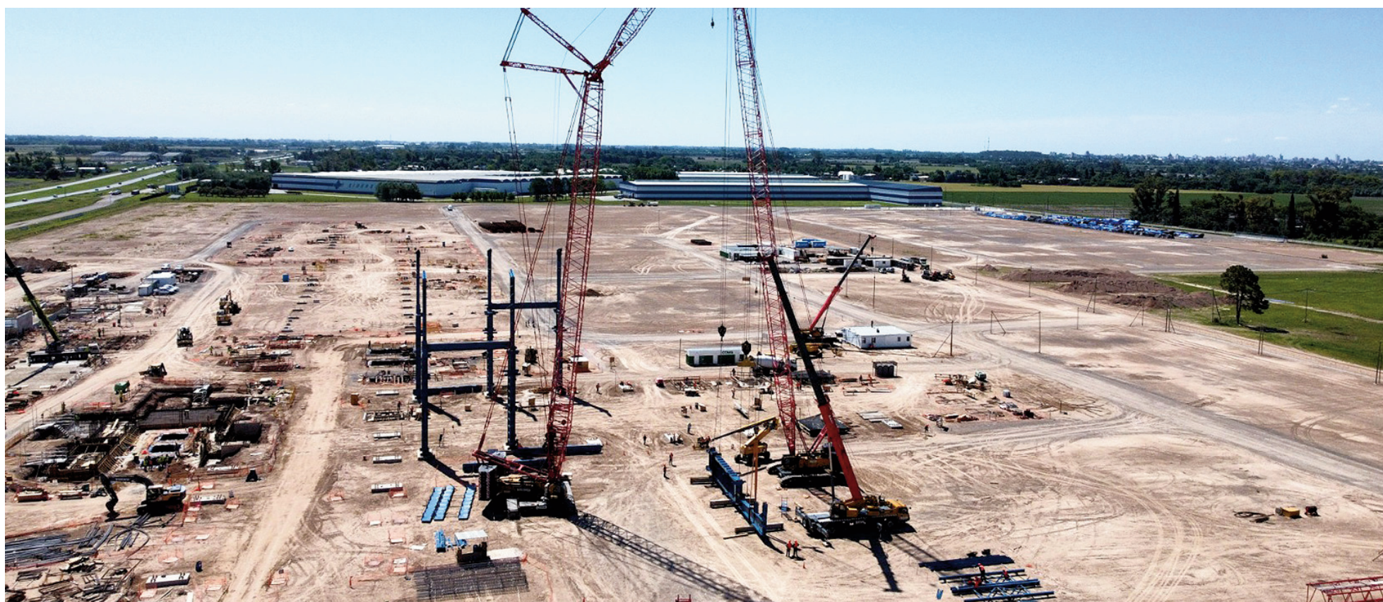
La obra se desarrolla de manera simultánea en distintos frentes, entre los que destacan la acería y el tren de laminación en caliente.
