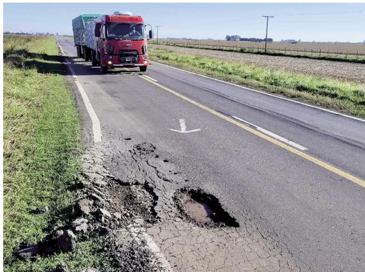
Las rutas argentinas, con déficits de mantenimiento.
