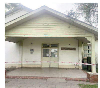
La explosión dentro del edificio educativo.
