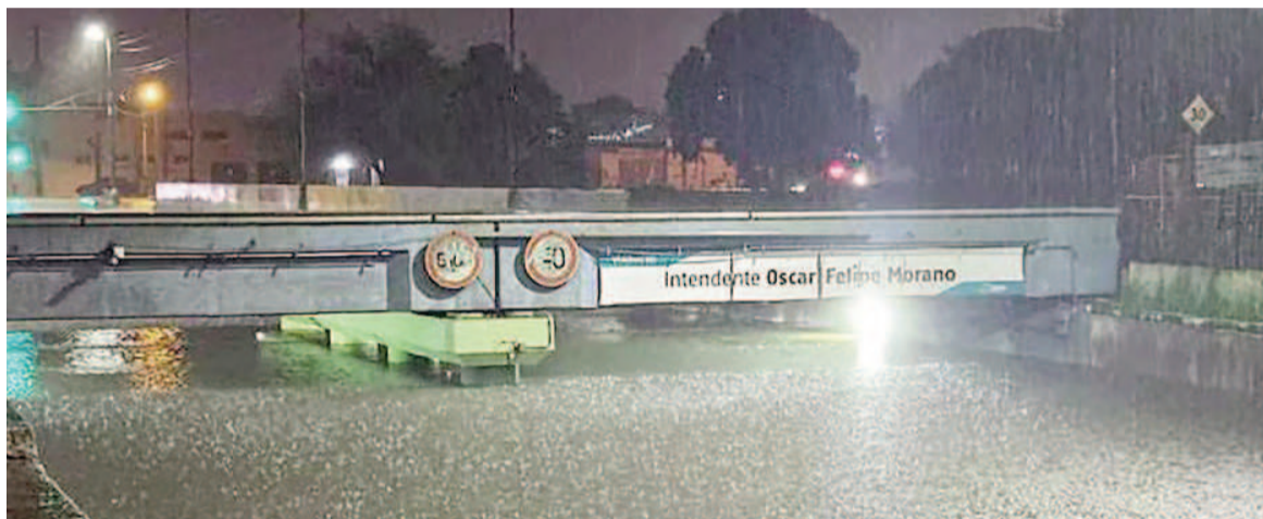
El viaducto de Zárate, totalmente inundado.
