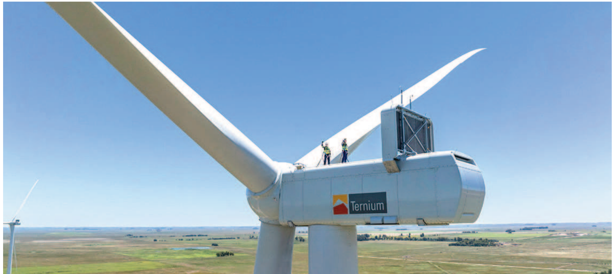
Para el transporte de las aspas de 75 metros de largo se tuvieron que adaptar todos los caminos de tierra que conducían al parque.
