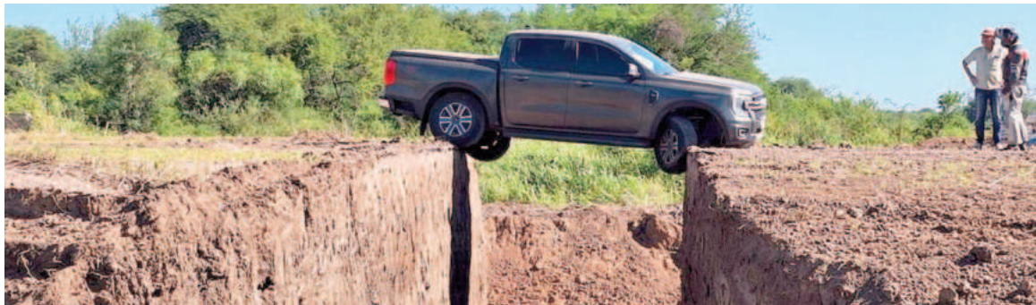
Insólito: una camioneta quedó "colgada" tras pasar por una obra mal señalizada.
