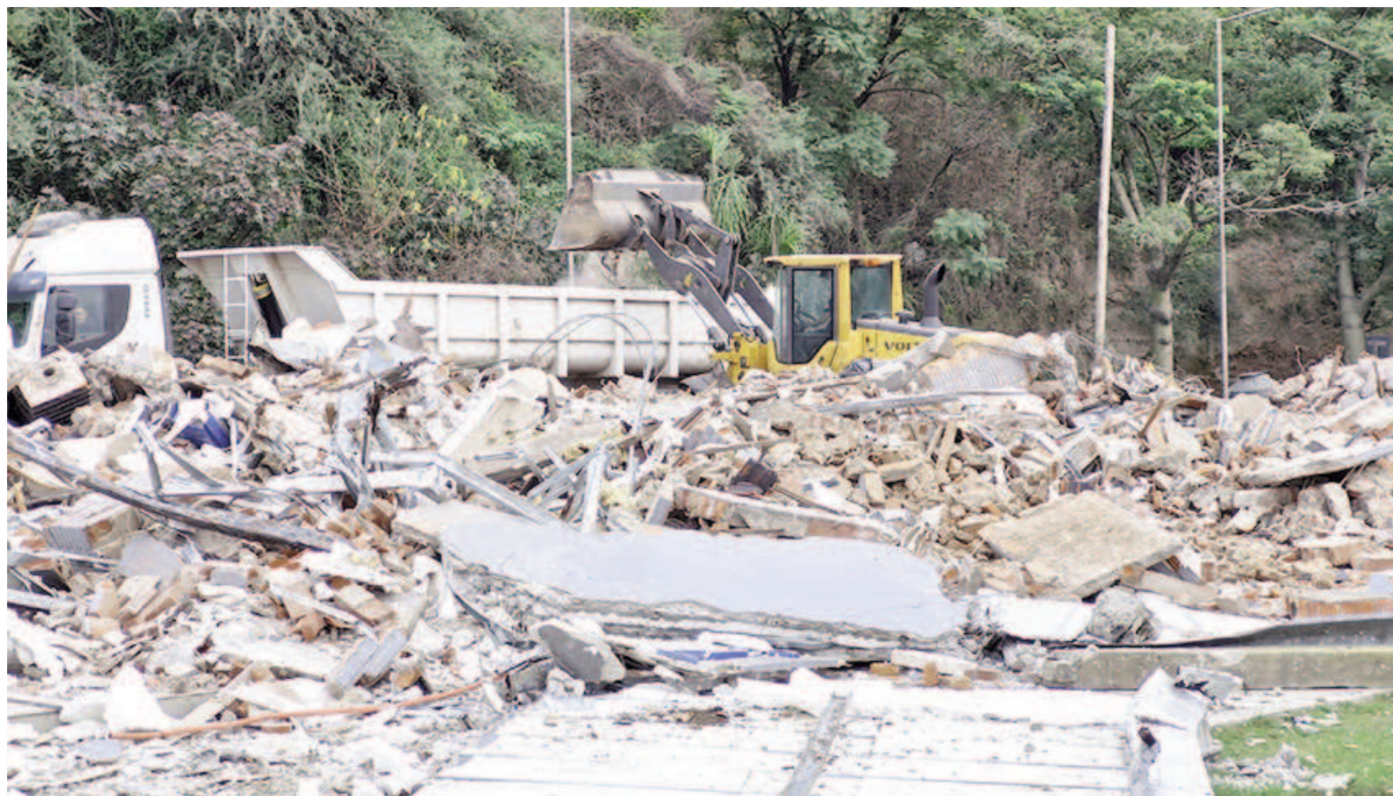
Personal municipal procedió a la demolición del edificio de la Estación Descubrí, en el ingreso del Eco Parque. EL NORTE
