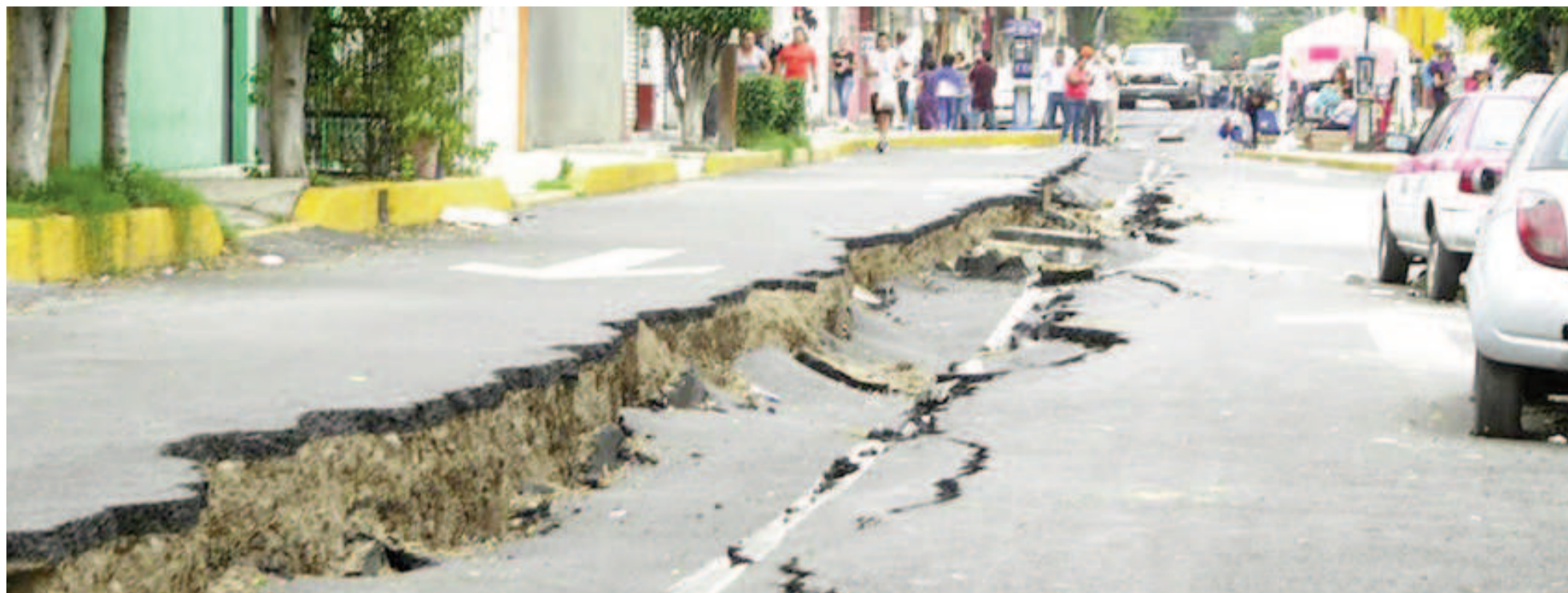
El hundimiento del terreno supone un mayor riesgo para carreteras, pistas de aterrizaje y cimientos de edificios, entre otras infraestructuras.
