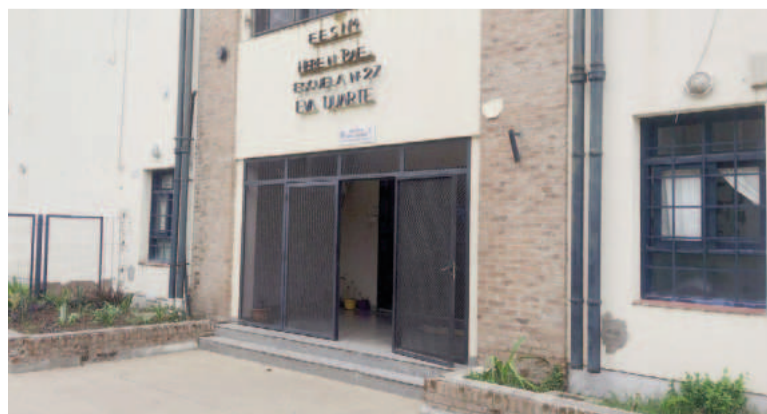
Escuela vandalizada pero sin signos de robo.
